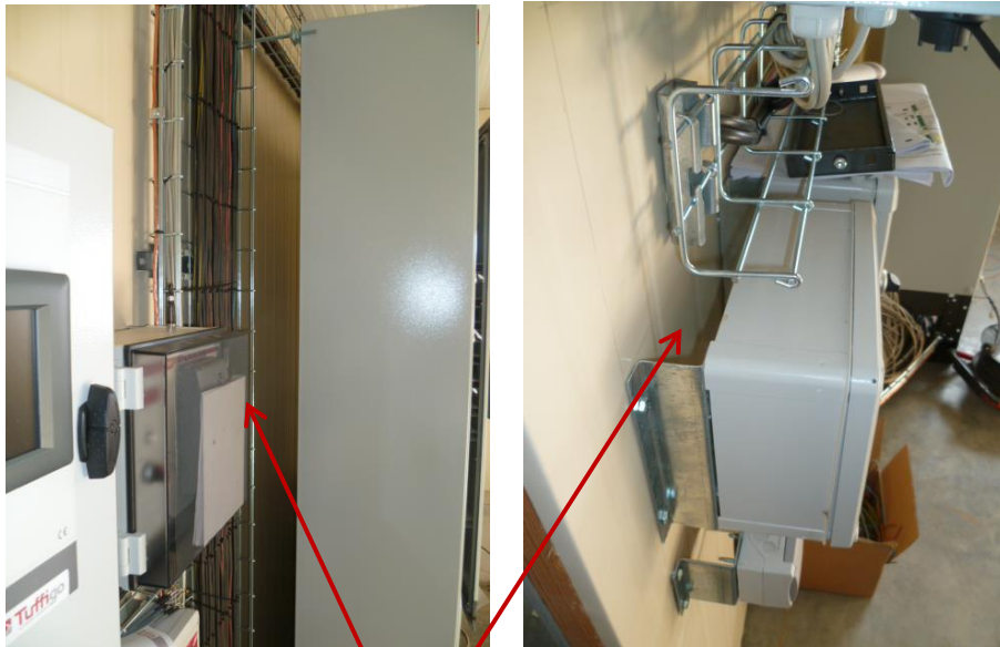
Armoire et coffret décollés
